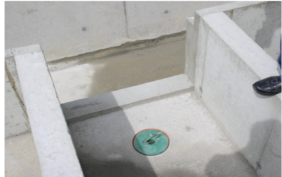
Zum Waschen des Zuluftkanals dient die Stauanase und der Stopfer.
